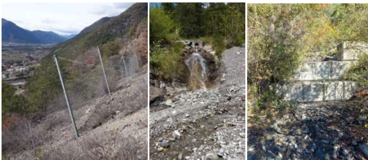
Figure : Exemples d'ouvrages de protection contre les aléas naturels sur le territoire de la CCSPVA. De gauche à droite : filet pare blocs protégeant le hameau des Celliers à Rousset ; exutoire d'un drain permettant l'évacuation des écoulements hors de la zone de glissement du bassin versant du Saint-Panrace à La Bâtie-Neuve ; seuil de correction torrentielle de la rase du Seigneur à Remollon
